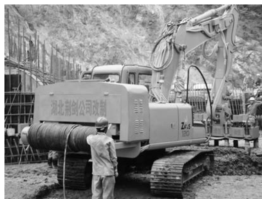
写真—6 中国電動式バイバック
