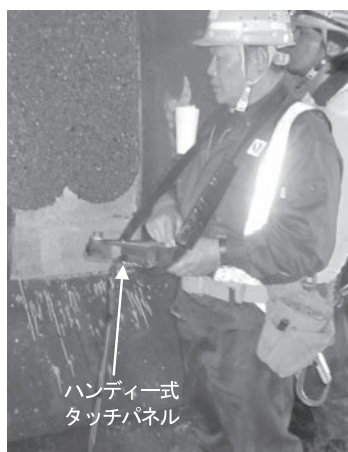
写真一 1 ハンディー式タッチパネルによる操作
