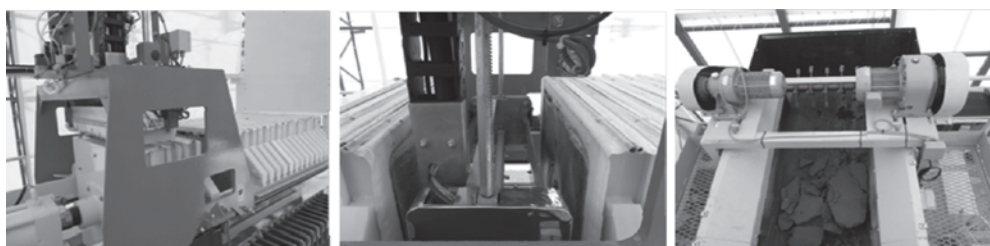
写真—3 濃縮残渣（脱水ケーキ）の自動掻取りと破碎の状況
