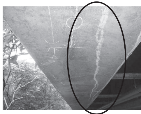
写真-2 桁下の橋軸方向クラック
