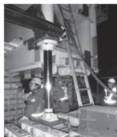
写真—13 走行ガーダー後端のたわみ出しジャッキ
