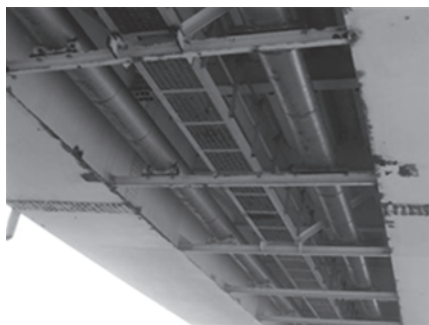
写真一三 ボルト、雨かきりのない下フランジが錆びる（三国大橋）
