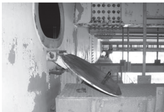
写真—4 鋼製扉の取付の配慮が不十分な例
