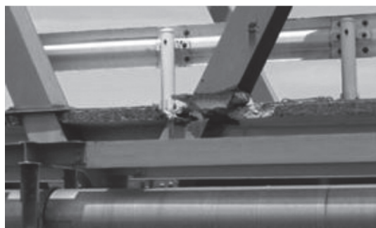
写真—7 トラス斜材の破断事例
