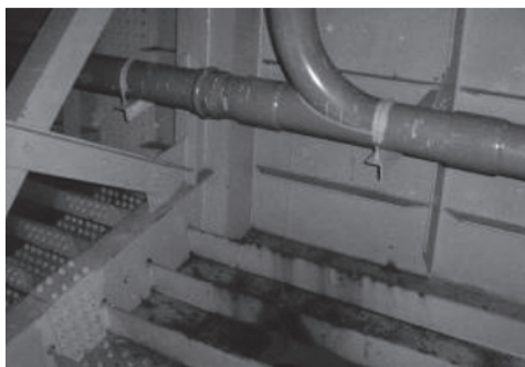
写真—8 箱桁内部への漏水・滞水の例
