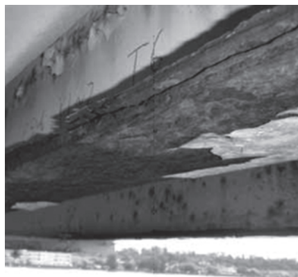
写真—1 河口部の橋桁の腐食
