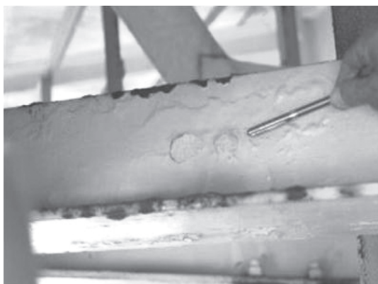
写真—5 しわ、縮みの発生事例
