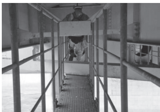
写真—5 部材の干渉により移動に大きな負担を伴う例
