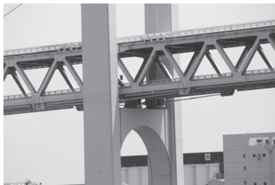
写真—2 塔部の橋軸方向変位制御装置
