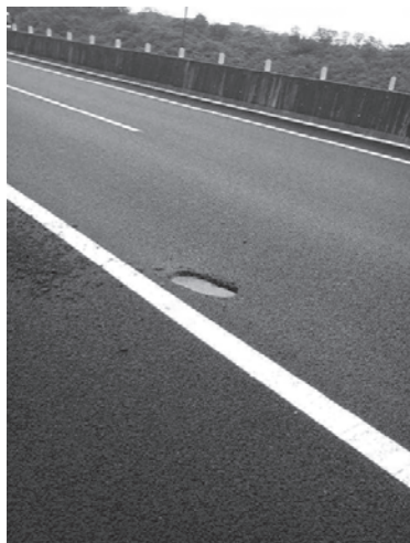
写真—1 舗装への損傷発生事例
