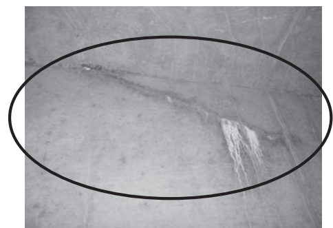
写真-3 橋梁端部クラック
