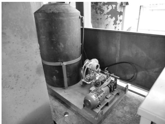
写真一5 水タンクと水ポンプ
