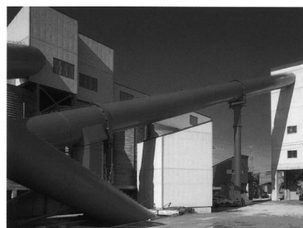
写真—10 骨材輸送用コンベヤ（円筒式）
