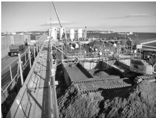
写真—10 プラント全景
