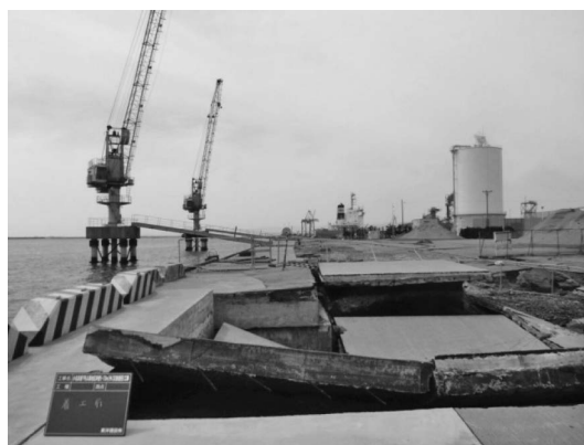
写真—2 被災した 7 号ふ頭岸壁（先端護岸）
