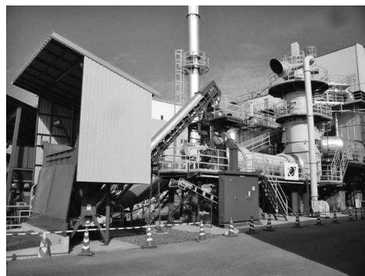
写真一 3 固形燃料燃焼システム全景
