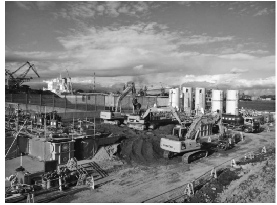
写真—11 プラント全景
