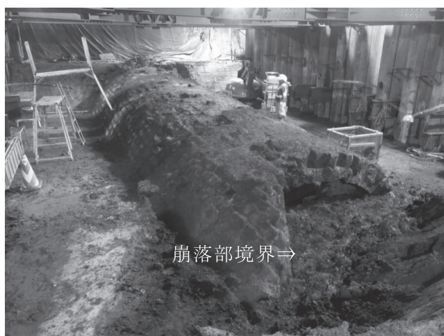
写真—16 崩落境界部上半
