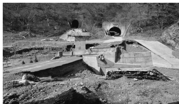
写真-1 ハイペ沢橋梁の被災状況
