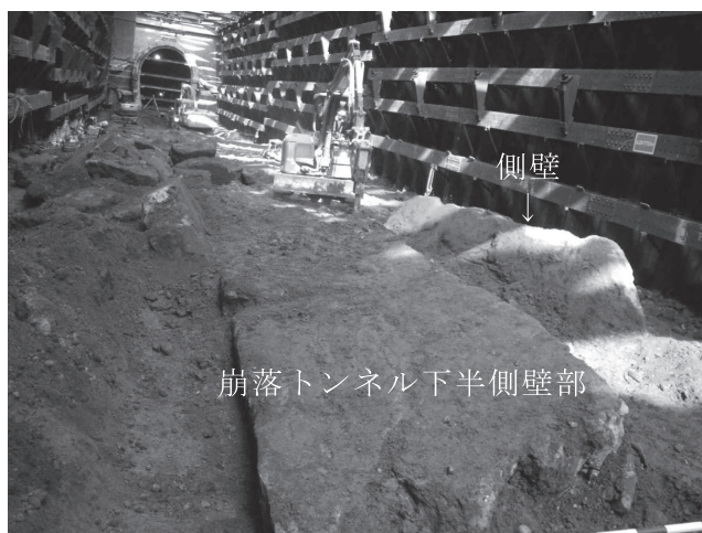
写真一14 崩落部下半側壁倒壊状況
