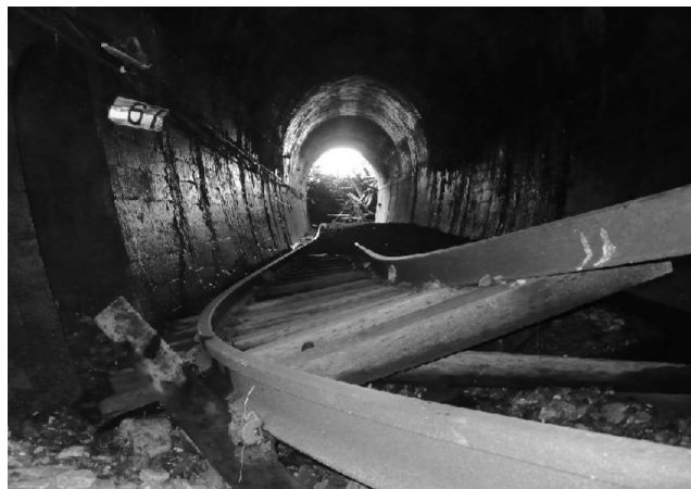
写真－2 坑内の被災状況
