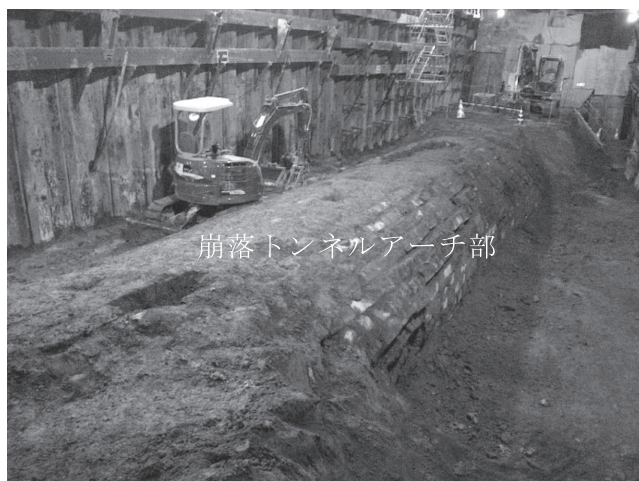
写真—15 崩落部上半アーチ部崩落状況
