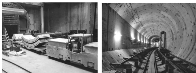
写真—3 坑内軌条設備
