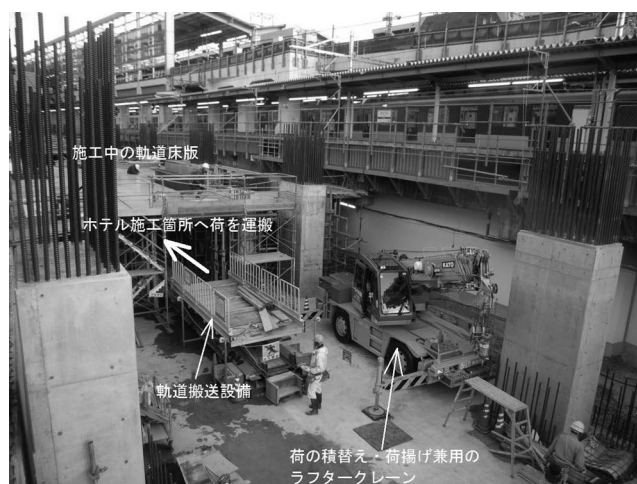
写真—5 軌道搬送設備
