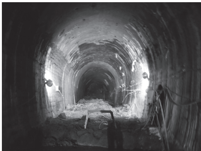
写真—4 トンネル崩落部からの土砂流入状況
