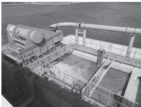
写真—8 振動ふるい（左）と調整槽
