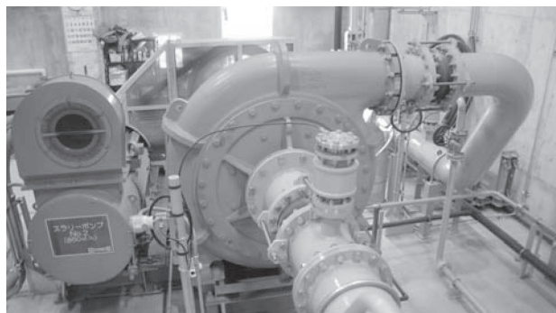
写真—9 スラリーポンプ
