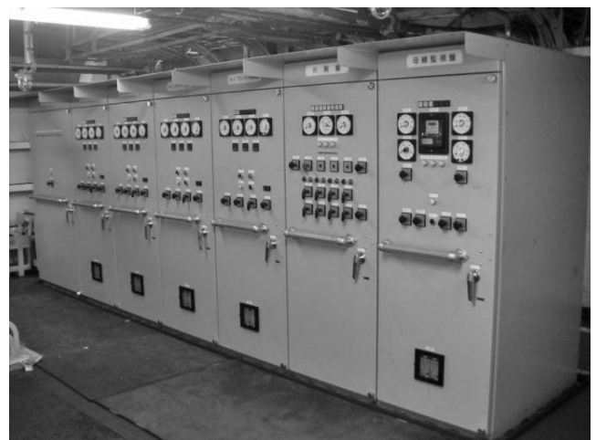
写真一八 発電機同期盤（機関室内）
