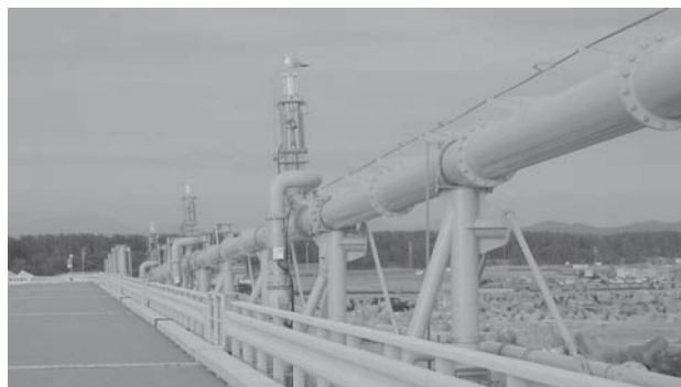
写真－6 傾斜のついたフルーム管
