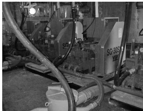
写真—10 スラリーポンプ (プラント室内)
