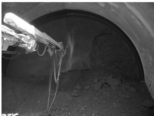
写真―7 崩壊した坑口部の切羽
