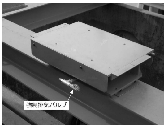
写真—5 エア抜きバルブ
