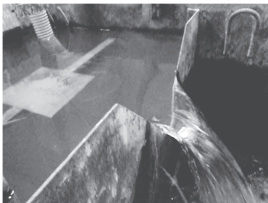
写真一 8 処理水の流下状況
