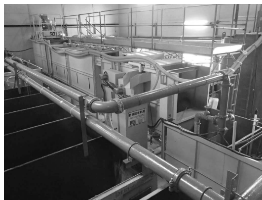
写真一3 設置事例 (NATMトンネル現場)
