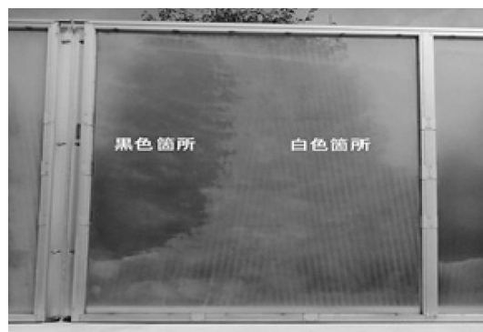
写真—1 透光板の劣化状況
