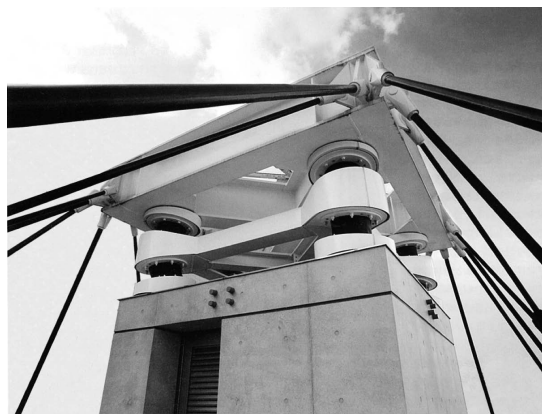
写真-2 コアシャフト頂部の免震装置 (積層ゴム 4 台 × 2 段)
