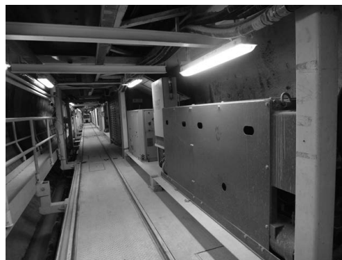
写真一4 TBM 後続 冷却設備搭載 (右側の設備)
