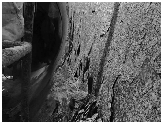
写真一七 TBM-1 山はね発生状況（左側壁部）
