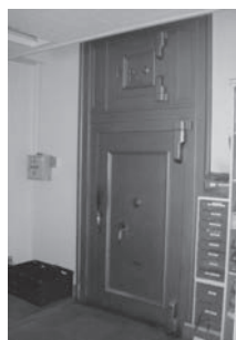
金庫扉（再利用）
