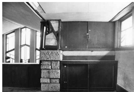
写真一 2 中央棟 FL ライトミニミュージアム 柱壁が外側に傾いている
