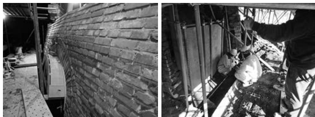
写真—10 アーチ上部の膨らみ
