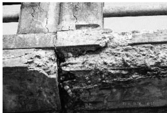
写真—5 大前橋・損傷部分(コンクリートのはく離)
