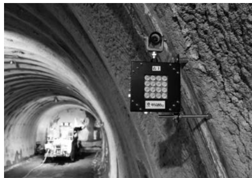
写真-1 受光センサー設置状況
