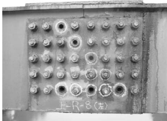
写真—3 三島大橋・損傷部（ボルトの脱落）
