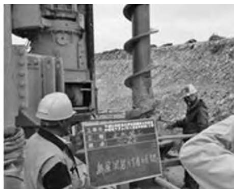
写真—1 不透水層土塊の付着確認状況
