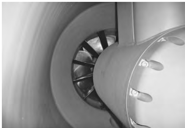
写真―2 水車内部の可変翼
