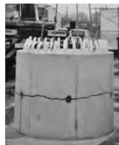
写真—1 ひび割れ状況
