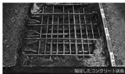
大型車等の影響による 床版の損傷
