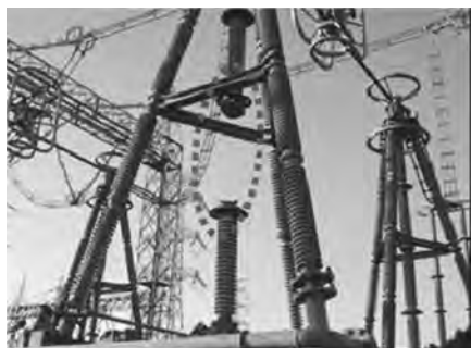
図—6（a）地震動により破損した断路器支持物
