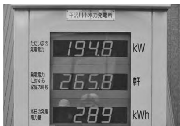
写真一8 発電出力パネル
