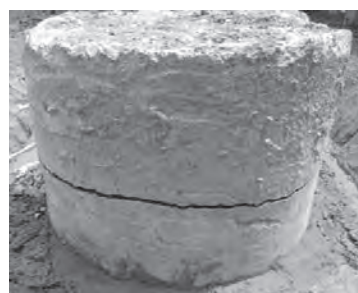
ひび割れ発生状況
