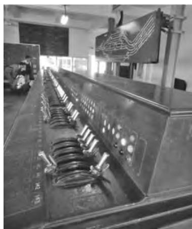
写真—5 老朽化が著しい現行機器室のリレー
