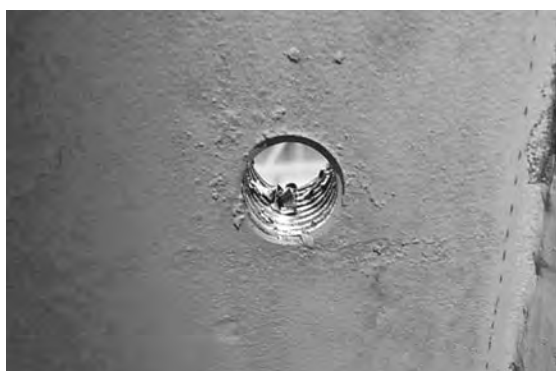
写真—5 後工程の配慮無 ボルト穴にゴミ
