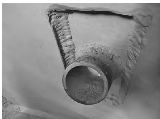
写真—6 後工程の配慮無 注入管ネジが塗装やゴミで汚い
