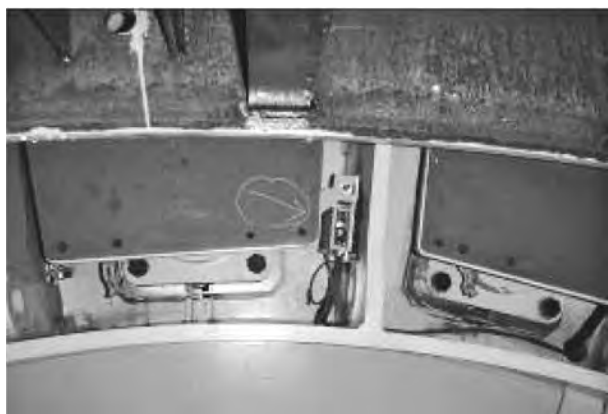
写真—4 計測ユニット設置状況
