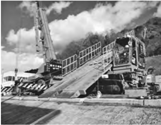
写真-4 MWP 全景
