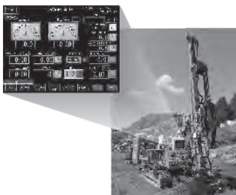
写真一 4 自動制御システム操作パネル
