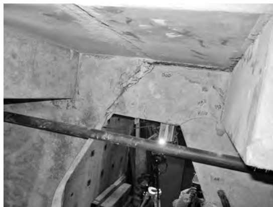
写真—3 上床版の接合部の破壊状況
