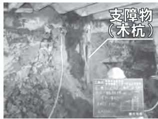
写真—9 支障物（木杭）
