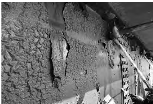
写真—1 塗膜剥離状況
