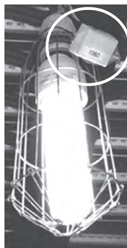
写真一3 仮設照明に設定した無線発信機
