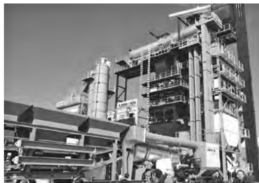
写真—20 骨材・コンクリートプラント
