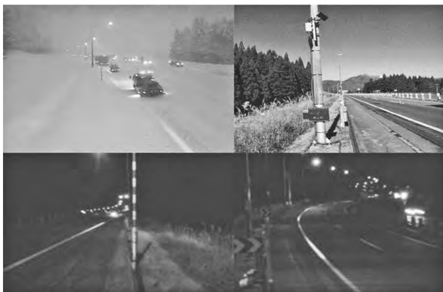
写真—3 関越自動車道 湯沢管内設置例
