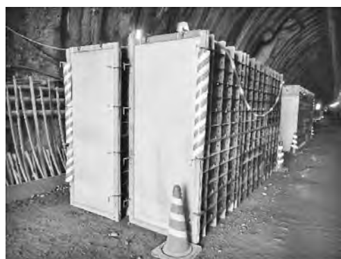
写真一1 現場に導入した本装置
