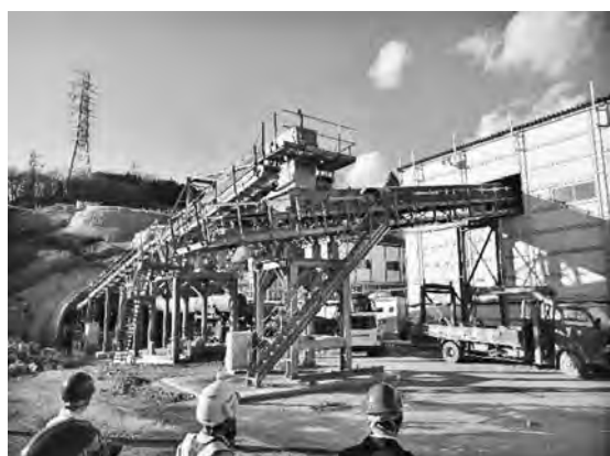
写真—10 連続ベルトコンベアシステム
