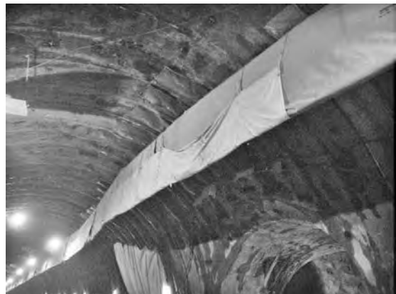
写真—6 風管に取付けた防爆シート
