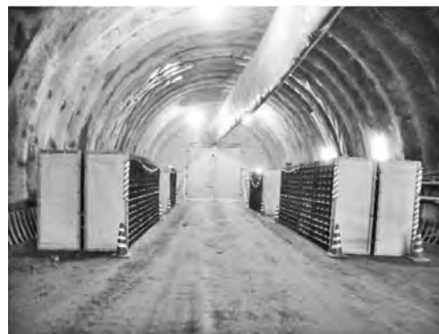
写真－3 本装置設置（通気抵抗体あり）
