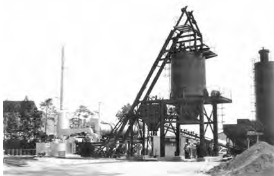
写真 4-17 ドラムミキシングプラント1号機 (DMT 30 t/h)
