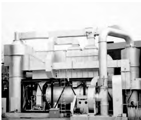
写真 4-31 TEC-R 型脱臭設備
