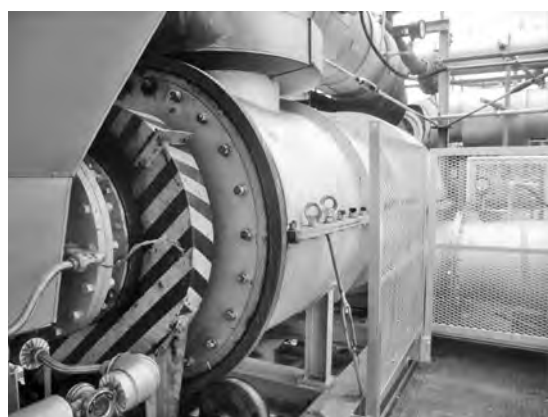
写真-3 熱分解炉 (U-ターンキルン)
