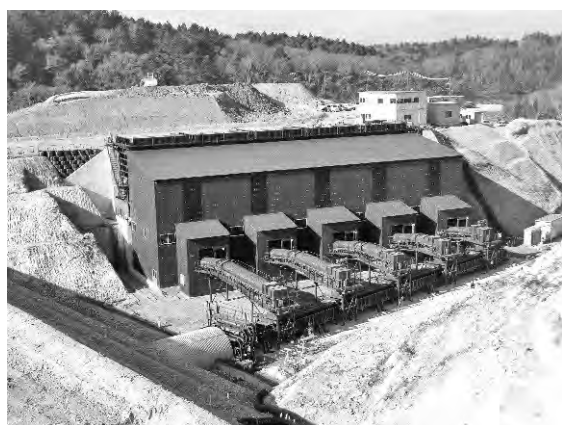
写真一八 破碎設備全景
