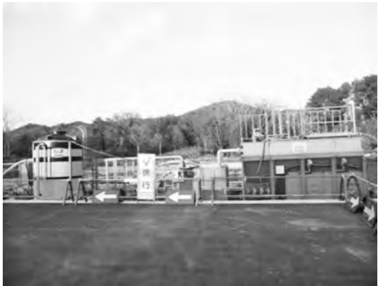
写真―5 ヒ素吸着設備
