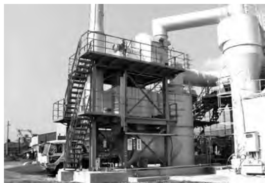
写真 5-14 1バーナ脱臭装置
