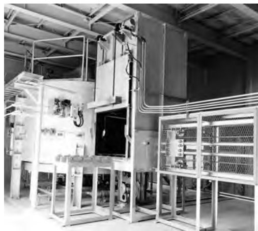
写真—2 焙焼実証設備の外観
