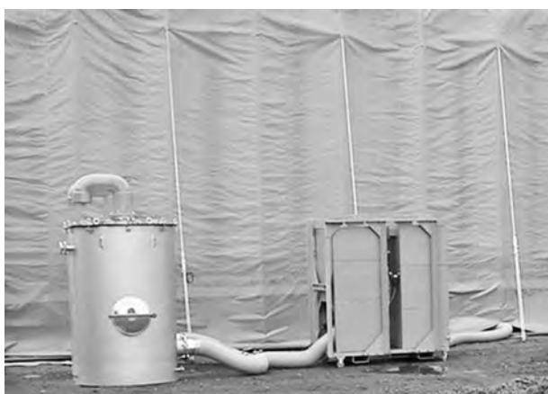
写真—6 テント内排ガス処理装置
