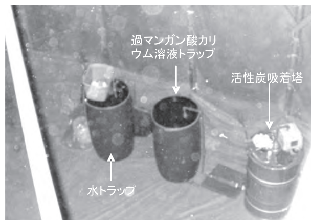
写真一 4 水銀除去装置
