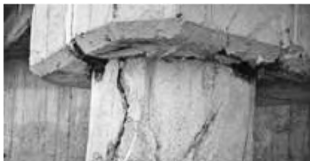
写真—2 交通インフラの老朽化
