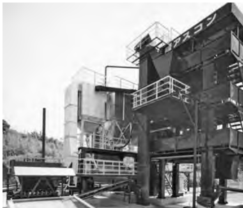
写真 5-8 TRC 型 リサイクルプラント
