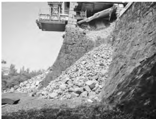
写真—10 東面崩壊後全景 (37% 崩落)
