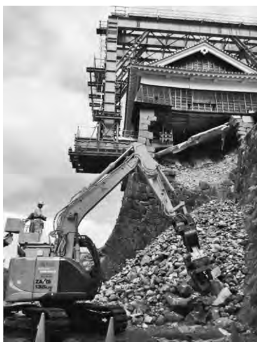
写真—13 崩落石回収状況
