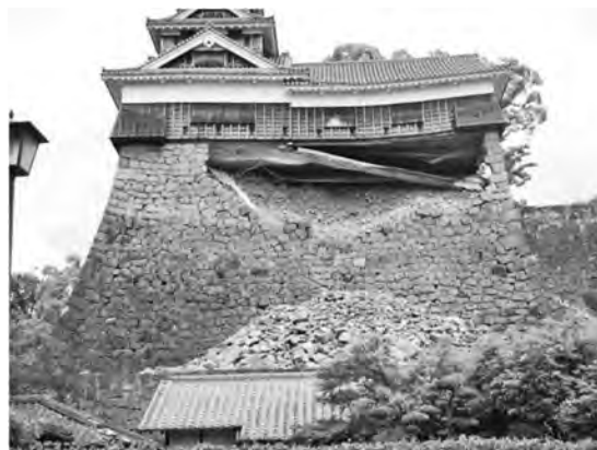
写真—9 南面崩壊後全景（約21%崩落）
