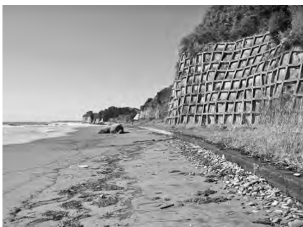
写真一4 海食崖を崖下から撮影（地点2）
