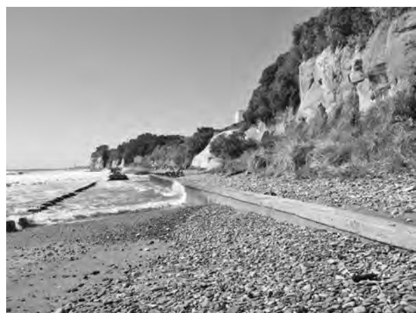
写真一5 波に曝された護岸（地点3）
