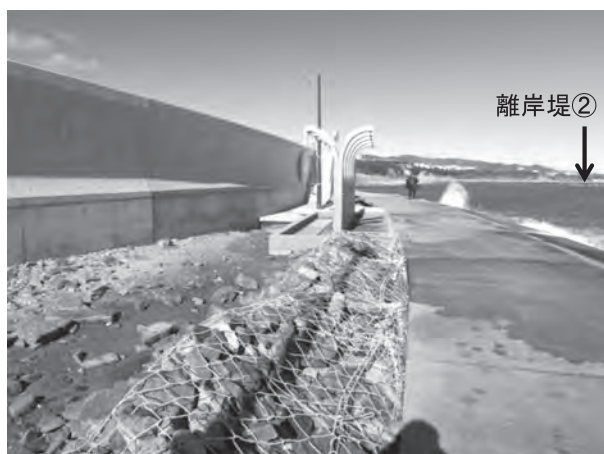
写真-2 護岸背後への越波により破壊が進む大型フトン籠(地点2)
