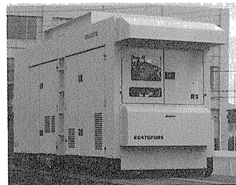
写真-11 コマツ EG 470 PDBS-1 エンジン発電機
