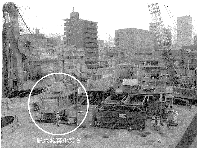
写真-1 RC 地中連続壁工事の安定液循環設備とリユースの脱水減容化装置設置状況
