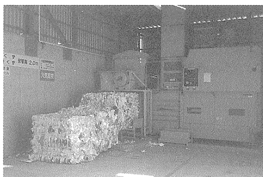
写真—7 圧縮梱包機の外形
