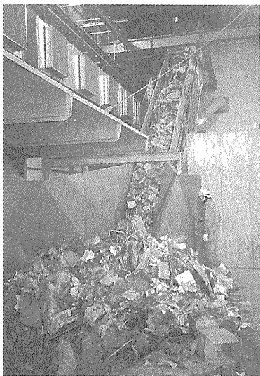
写真-3 混合廃棄物供給ホッパ部
