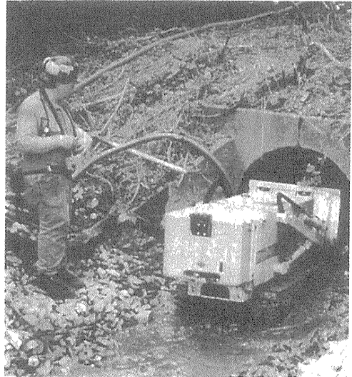
写真—1 作業員はリモコンを使って安全な場所からMT 346を蛇が棲息するボックスカルバートに導入する
