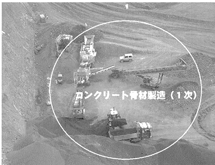
写真—1 破碎機の稼働状況写真 (1次破碎設備)
