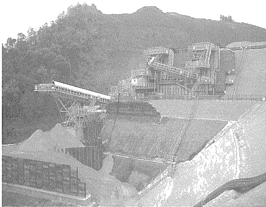
写真—1 投入破砕設備
