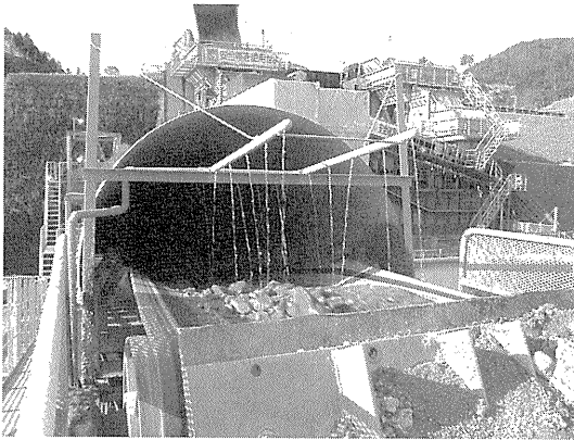
写真—3 散水設備
