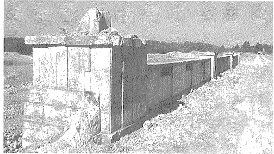
写真-1 発見されたコンクリート製旧高欄
