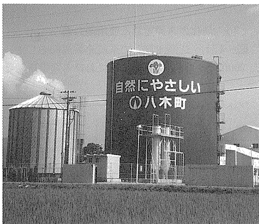
写真-1 メタン施設写真 (右：消化槽，左：ガスホルダ)
