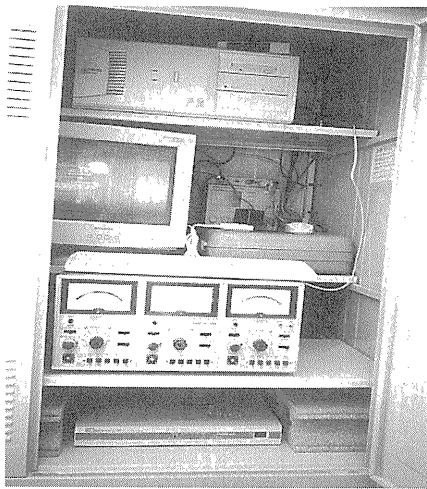
写真-2 計測機器設置状況 (内部)
