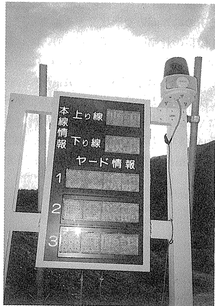
写真-4 混雑状況表示板
