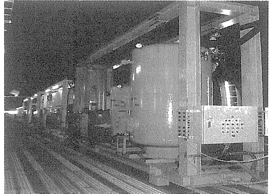
写真-1 リザーバタンク
