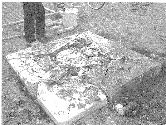
写真—8 破碎状況
