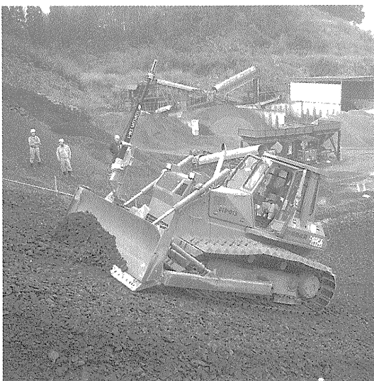
写真—9 2割5分勾配（21.8度）で仕上げ整形作業中の三次元マシンコントロールブルドーザ
