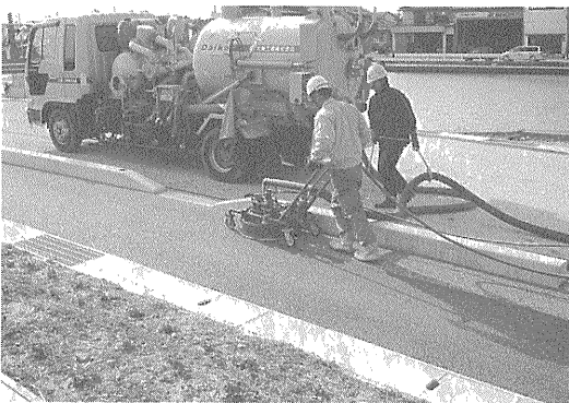
写真—4 舗装表面洗出し施工 使用水：250 MPa×30 L/min 使用機器：台車式ノズルユニット
