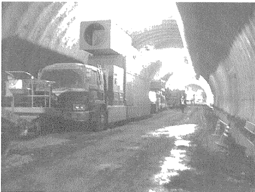
写真-2 テスト機運転状況
