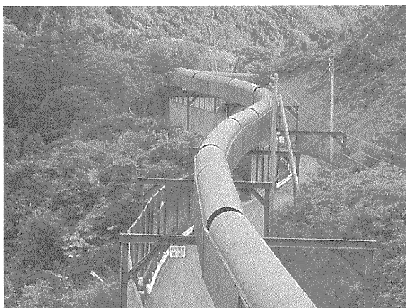
写真—1 U型トラフカーブコンベヤ近景
