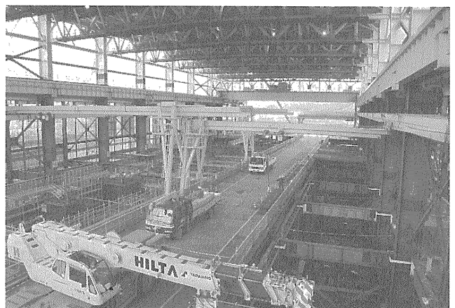
図-11 タービン建屋内部
