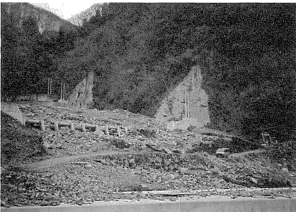
写真-1 流出土砂堆積状況
