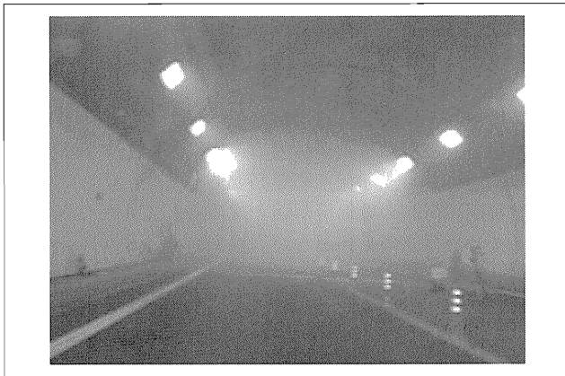
写真-3 水噴霧設備の噴霧状況
