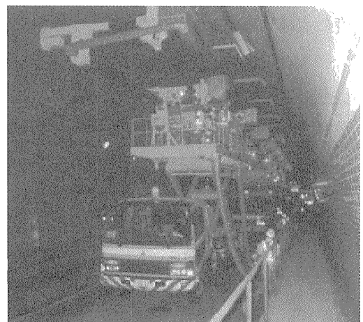
写真二 水噴霧設備点検車（点検風景）
