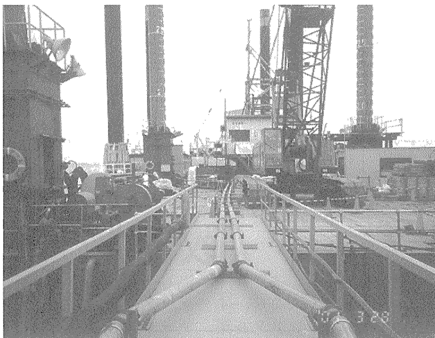
写真-7 SEP 上配管状況
