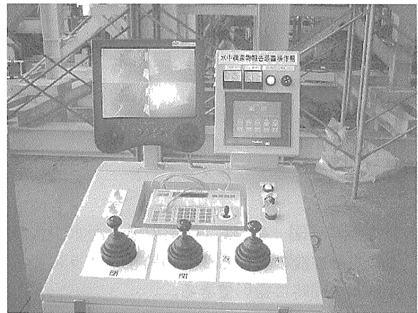
写真-2 遠隔操作盤
