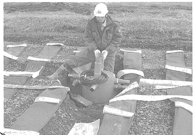
写真-2 主分離タンクの設置状況
