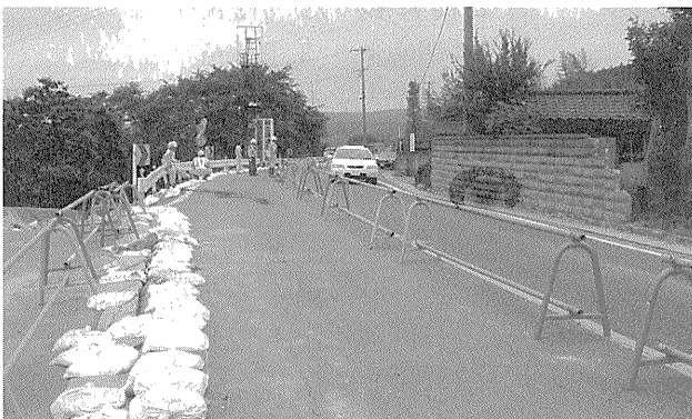
写真—4 一般国道108号路肩の陥没
