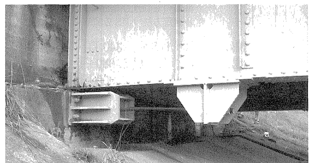
写真-3 小野橋の落橋防止構造（張力が作用した状態であり、落橋防止が有効に機能したと推定される）
