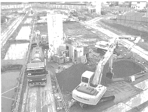
写真-5 汚泥改質全景
