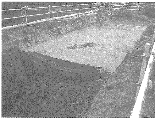
写真-9 汚泥凝結状況
