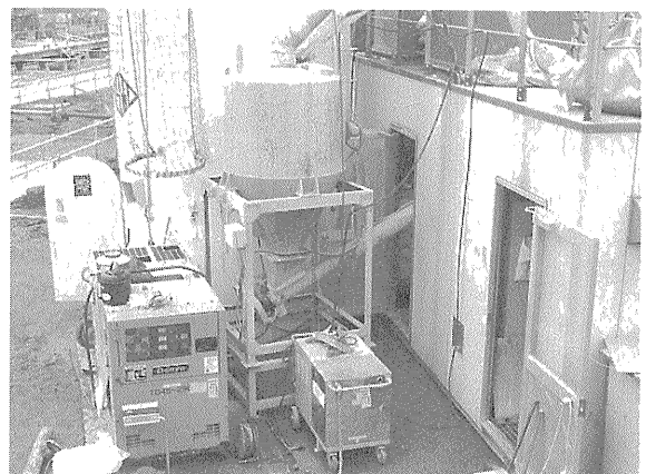
写真-3 改善固化材供給装置 (レシーバタンク)
