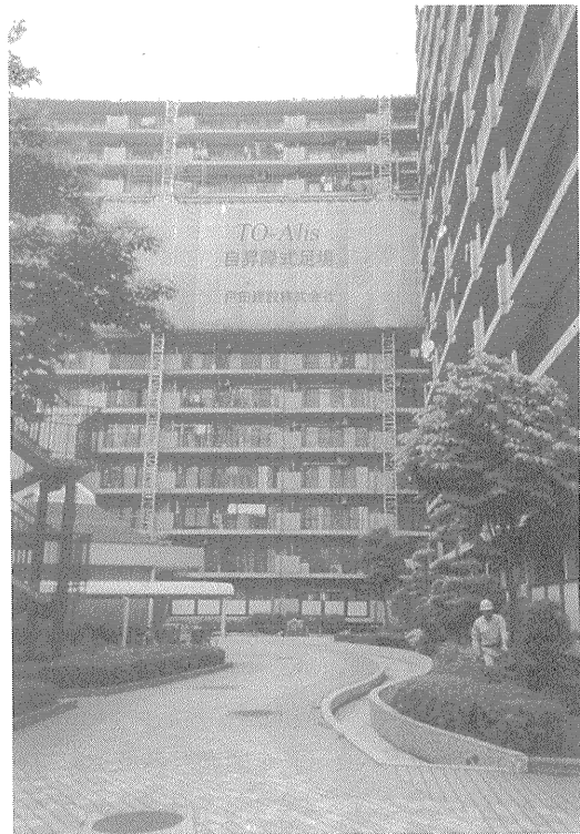
写真一1 マンション外壁への設置状況
