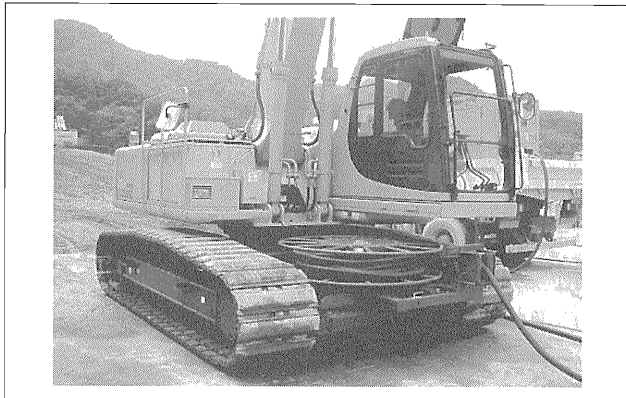
写真-2 下部走行体に搭載したケーブルリール
